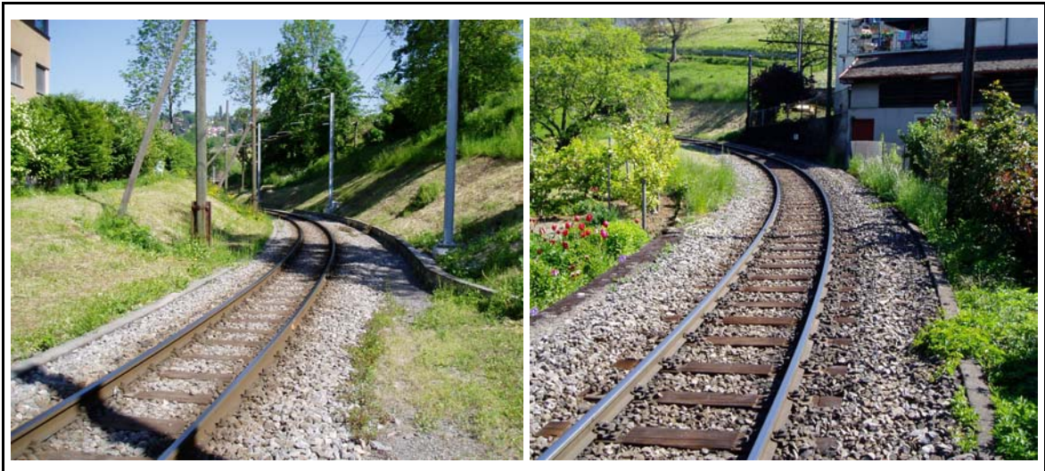
Abbildung 5-1: Ansicht der neuralgischen Bögen bei Fontanivent talwärts (links) und Sonzier bergwärts (rechts)
