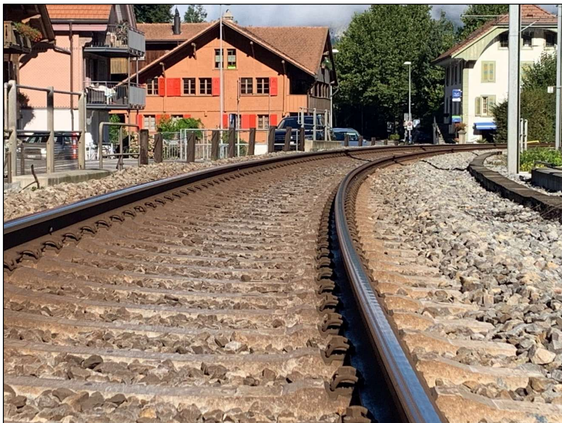
Abbildung 2-1: Schlupfwellen in Därligen im Gleisabschnitt 4 Innenschiene am 03.9.2019
