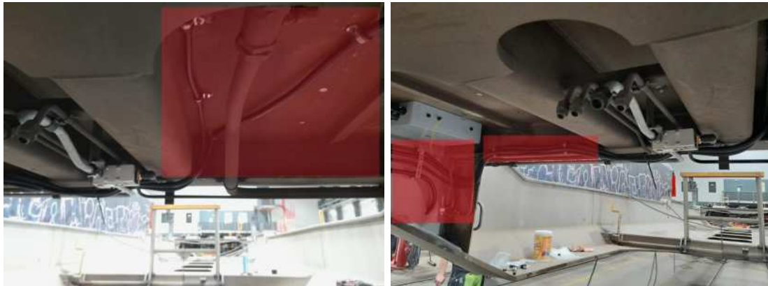
Abbildung 7.3: Führung der Kabel und Gleitschutzrechner im Untergestell mit Darstellung möglicher Verblendungen [eigene Darstellung].
